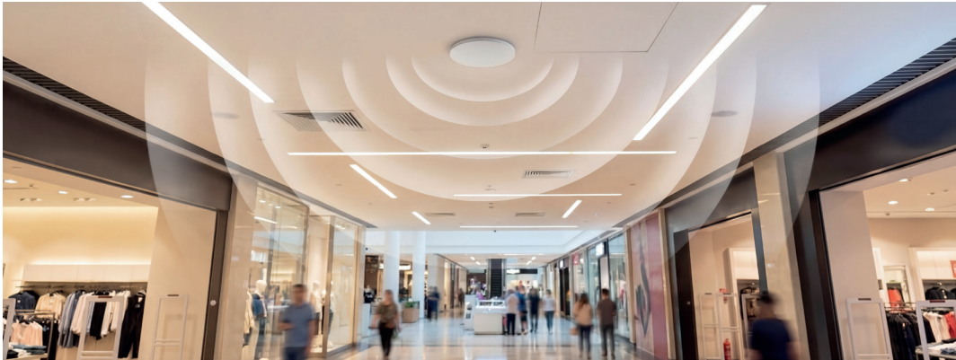
Unauffällig installierte Indoor-Antenne in der Zwischendecke eines Einkaufszentrums zur Sicherstellung der Netzabdeckung
