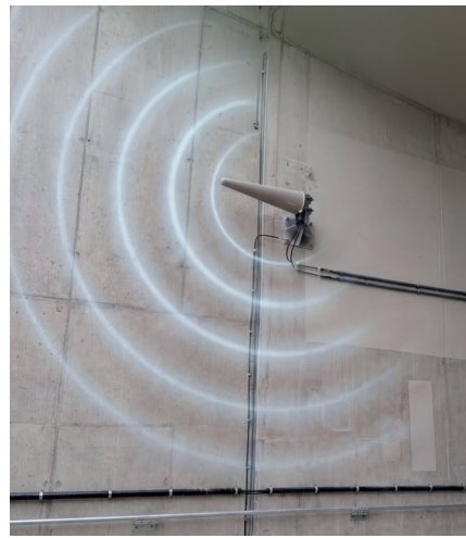
Antennensystem zur gezielten Funkabstrahlung und lückenlosen Versorgung im Tunnel
