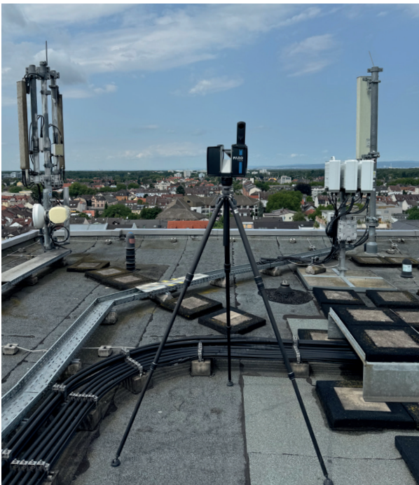
Bestandsaufnahme für einen Mobilfunkprovider
