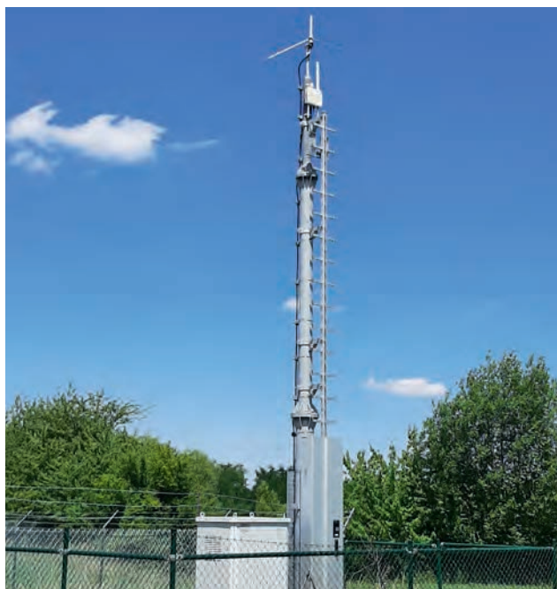
Basisstation mit Technischschrank und Fundament
