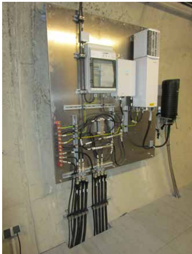
Ansicht Repeater mit Koppelnetzwerk in einem Verbindungsbauwerk. Die zahlreichen LTE-Antennen stellen Geschwindigkeiten von bis zu 1.000 MBit pro Sekunde bereit.
