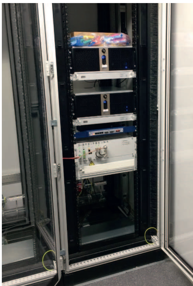
Installierter redundanter Switch (oben) und Basisstation (unten)
