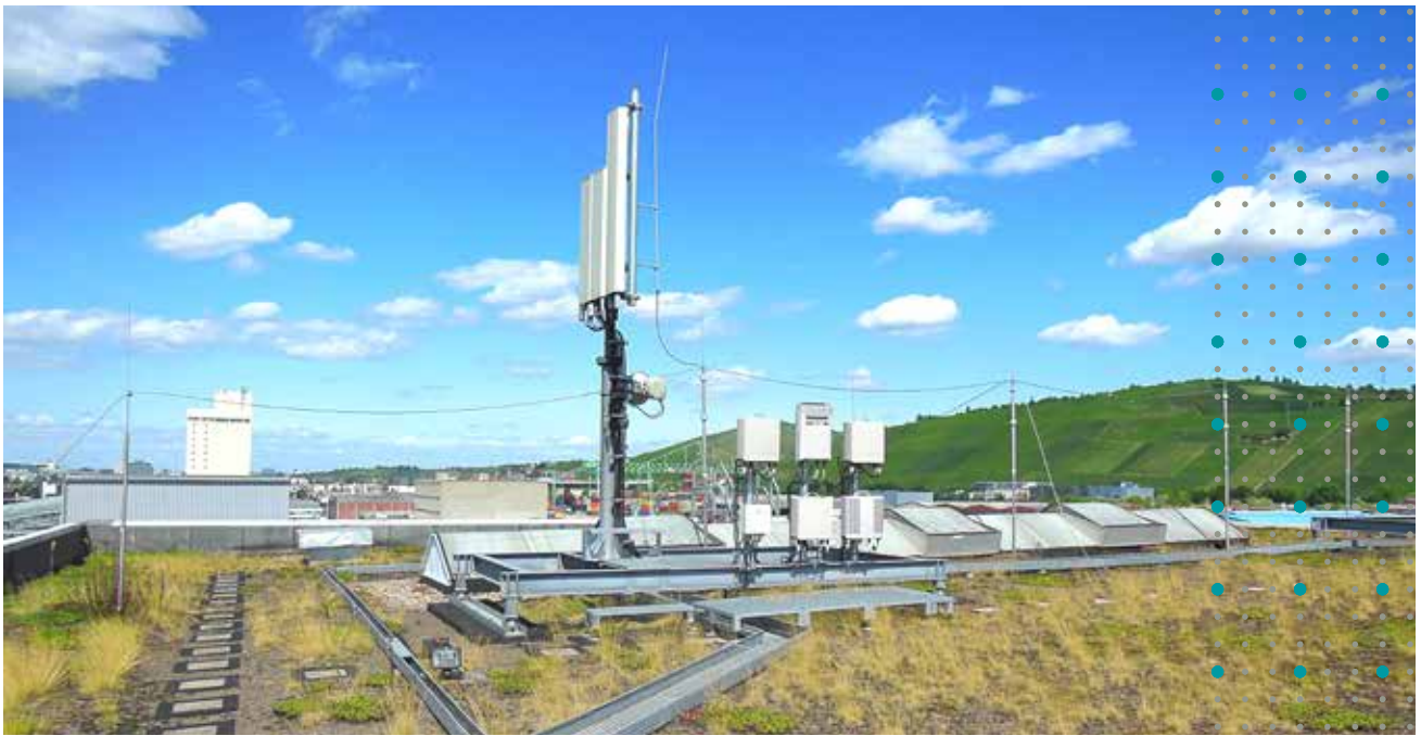
Mobilfunkantenne auf einem Gebäude
