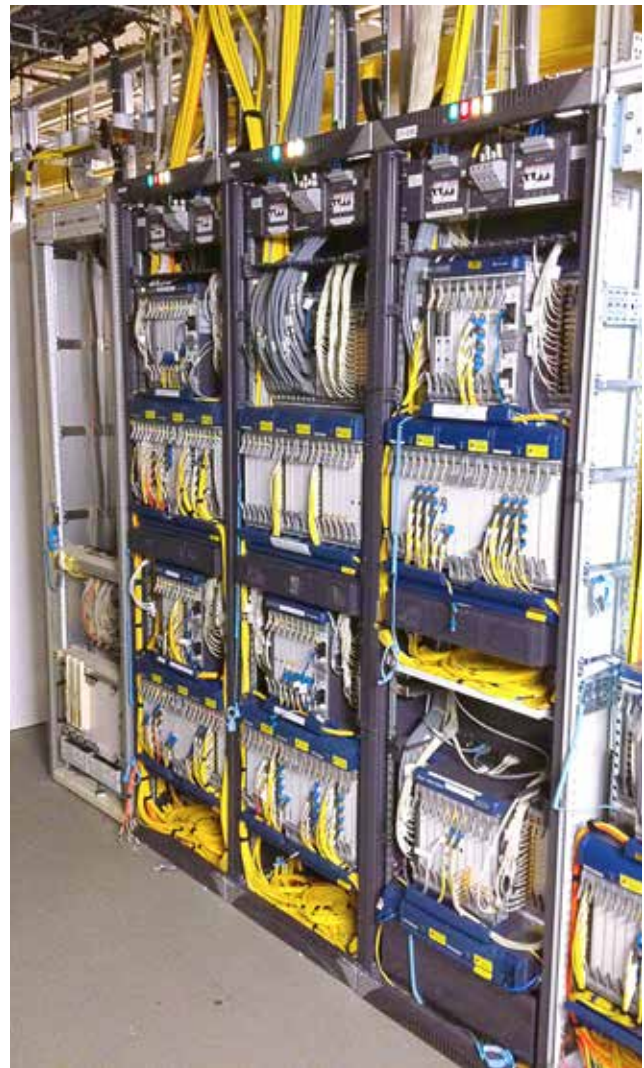
DWDM-Geräte der Firma Huawei in einem Technikstandort in Stuttgart
