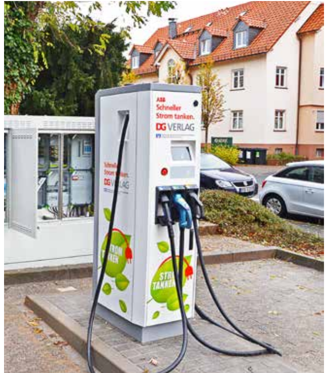
SCHNELLLADESTATION AUF DEM BETRIEBSGELÄNDE DES DG VERLAGES IN WIESBADEN
